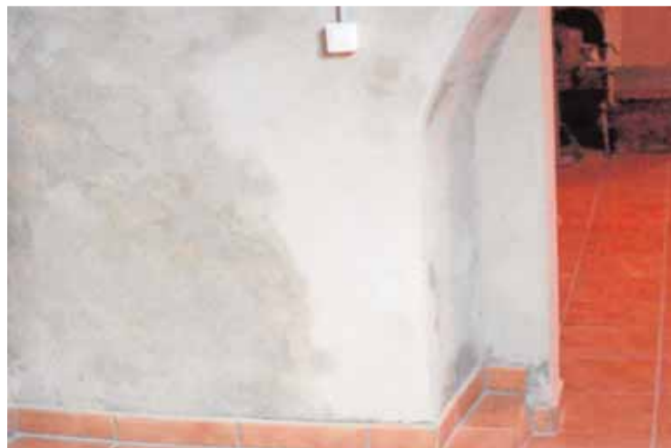
Aspecto de una pared afectada por la humedad. LP
