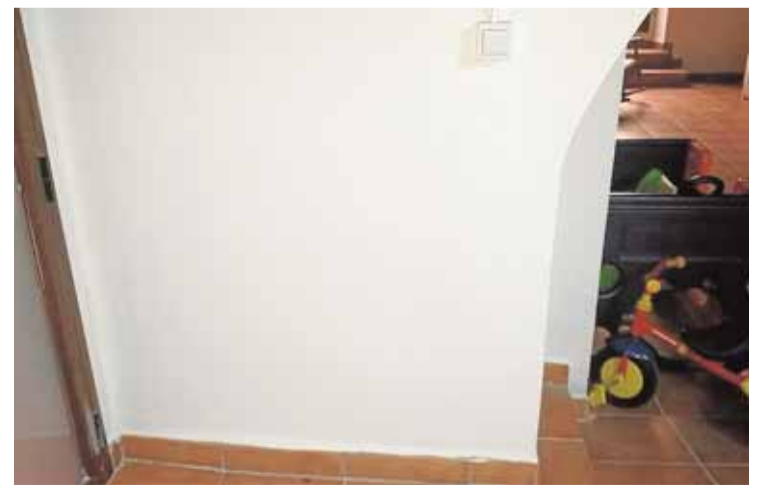
La misma pared después de instalar el sistema HS-221. LP
